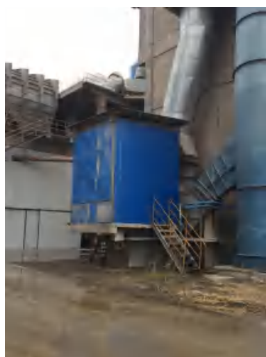
煤磨风机隔音板
