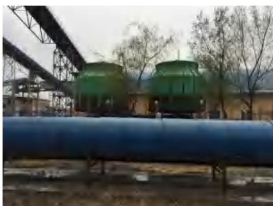
水泥生产循环水系统
