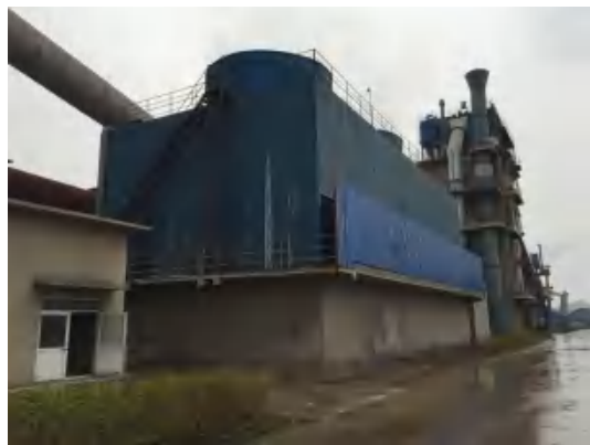
余热发电循环水池隔音板
