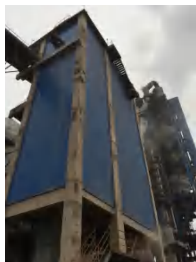
原料磨提升机隔音板
