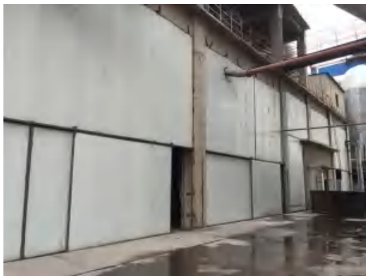
篦冷机高压风机隔音板（东侧）
