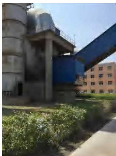
窑头袋收尘风机隔音板
