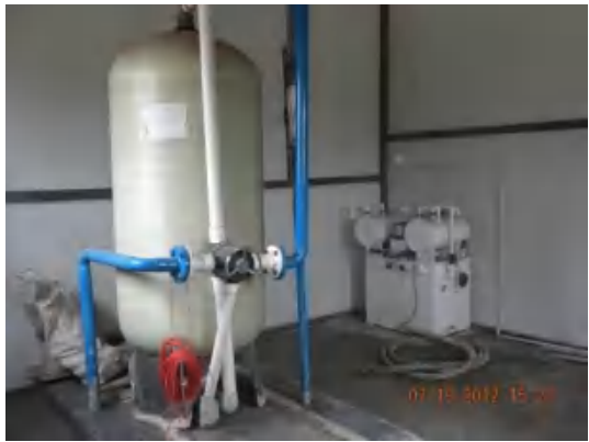
中水处理装置(照片 2)
