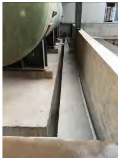
氨水罐区围堰及事故池导流槽
