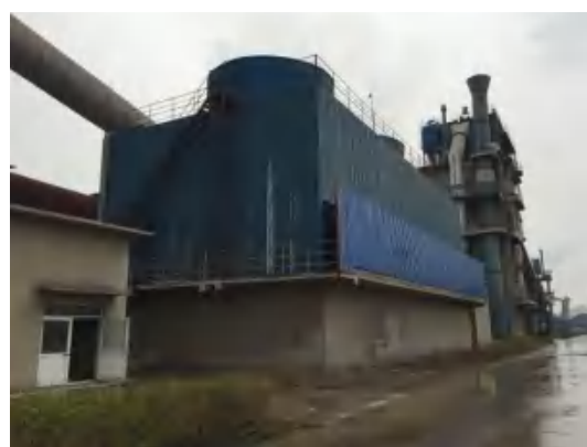
余热发电循环水系统
